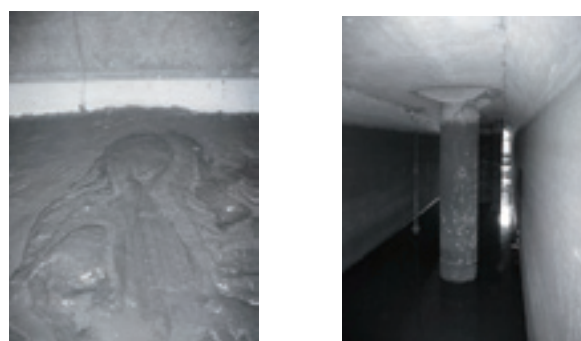
Fig. 7 機械排水ポンプ取水口付近の底泥 (左), 取水口 (右)
