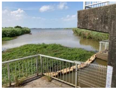
①侵入防止フェンス
