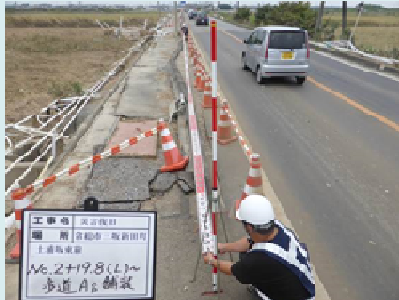
被災状況の調査 【(公社)茨城県測量設計コンサルタント業協会】
