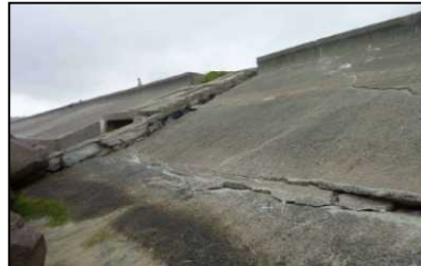
海岸堤防の破損（海水侵入の恐れ）
