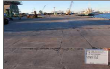
舗装損傷（物揚場利用への影響）
