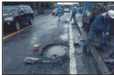
舗装の劣化による損傷（車両通行に影響）
