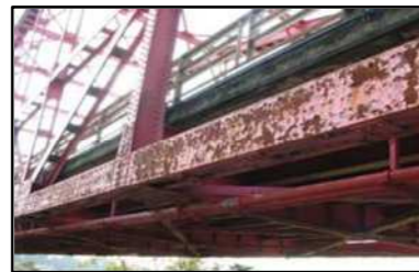
塗装の劣化による鋼材の腐食（車両通行止めの懸念）
