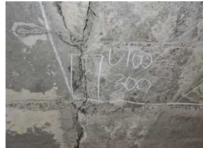
②材質劣化
