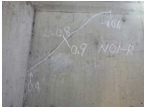
①ひび割れ
