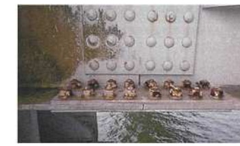
ボルトの腐食
