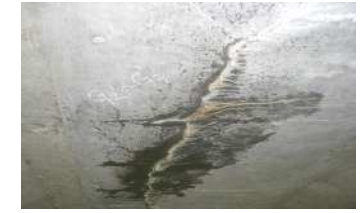
漏水・遊離石灰
