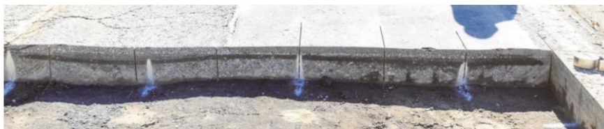
写真 3.2 車輪通過部において路盤以下の層が沈下している例
