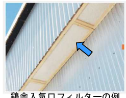
鶏舎入気口フィルターの例 〔粉じん、羽毛等の取込み対策にフィルター等を設置〕
