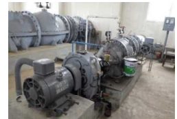
用排水ポンプ設備
