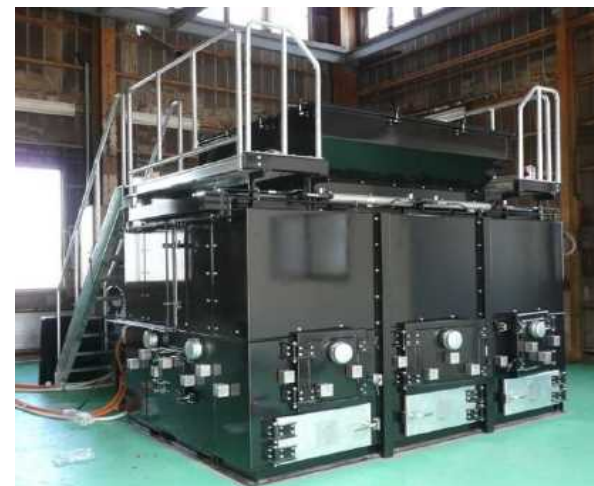
炭化灰化処理装置
