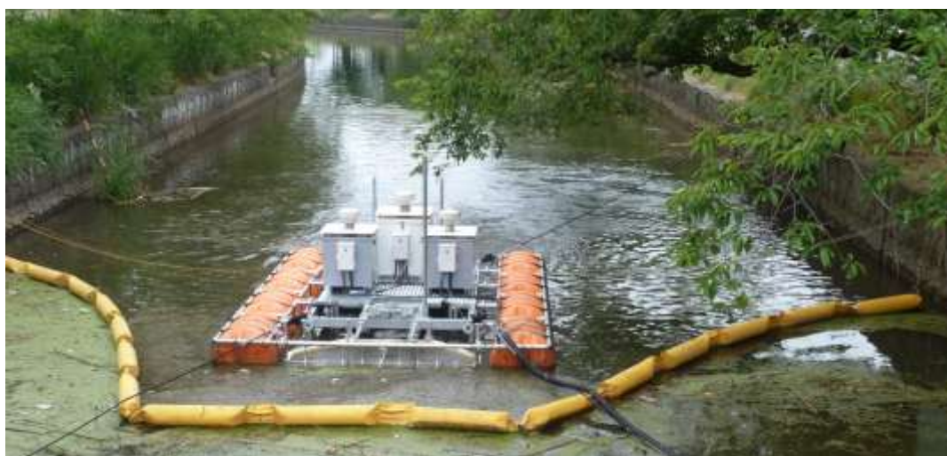
図 新川に設置されたアオコ抑制装置（平成24(2012)年7月）
