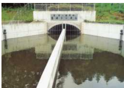
筑波トンネル入口（吐出水槽）
