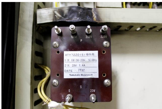
図 17 焦げ跡を確認した変圧器の状態
