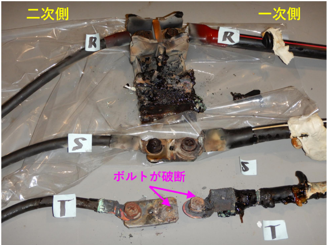
図8 チラー冷凍機本体から取り出した電源端子部の状態
