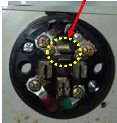
200V コンセントの内部
