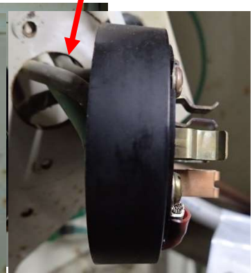
200V コンセント裏側
