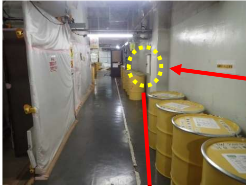
電源盤の周辺
