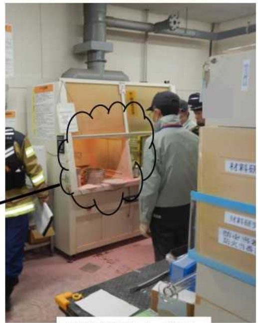
◎精密測定室 フード写真
