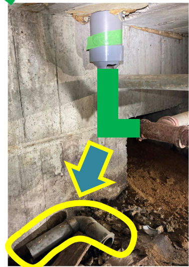
脱落箇所 B
