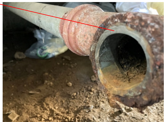
【金属チーズ接続部】
