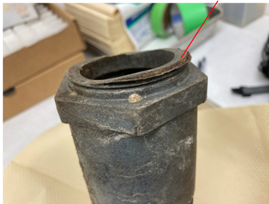
【エルボ管バルブソケット破損状況】
