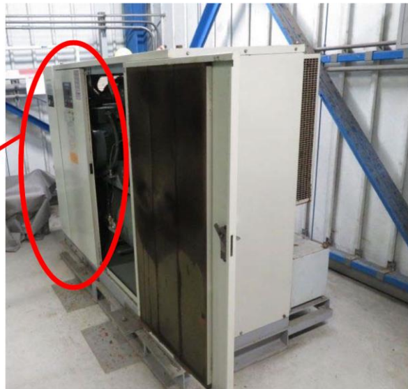
空気圧縮機外観
