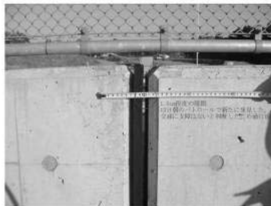
ダイレクトアクセス擁壁の隙間
