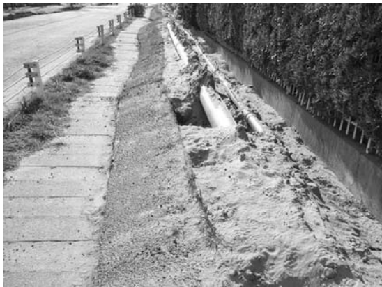
液状化現象により地上に浮上した水道管
