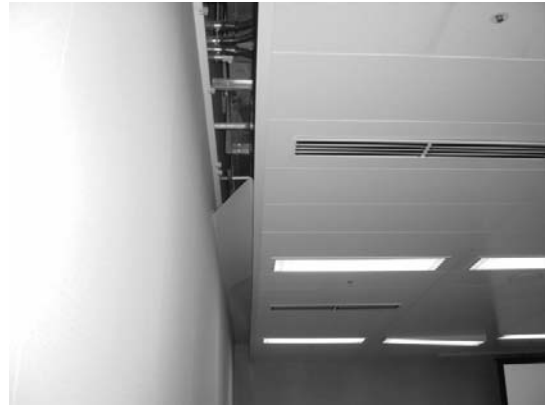
小会議室（天井パネルずれ）
