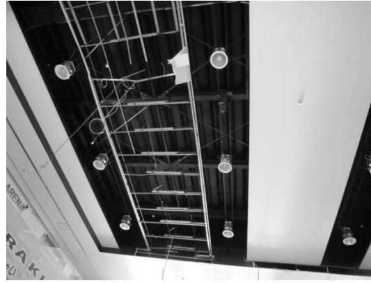
崩壊直後（ロビー天井）
