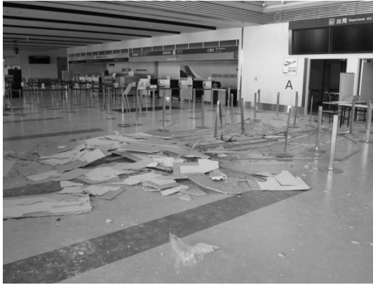
崩壊直後（1階ロビー）
