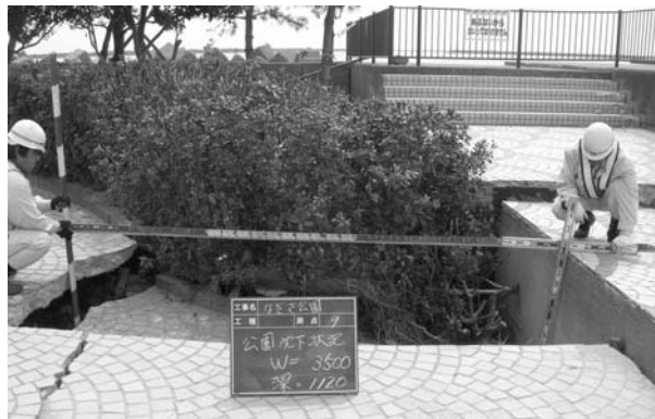
震災による道路等の被害状況調査
