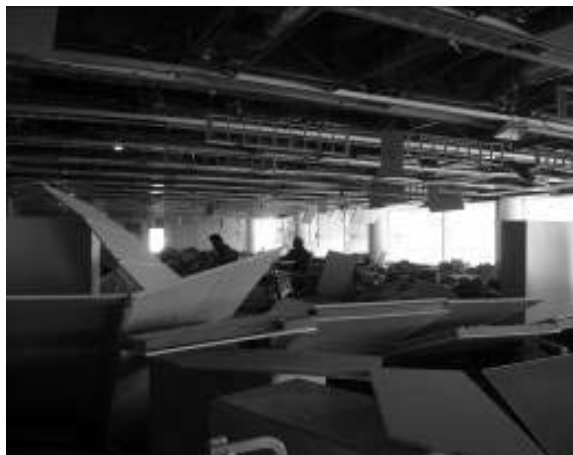
土地開発公社事務室の被害状況
