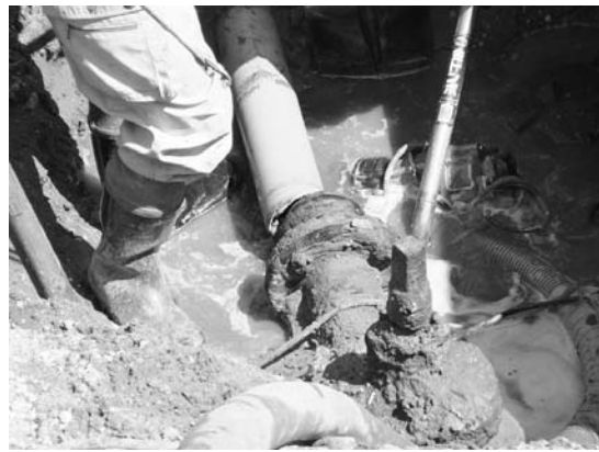
水道管の損壊
