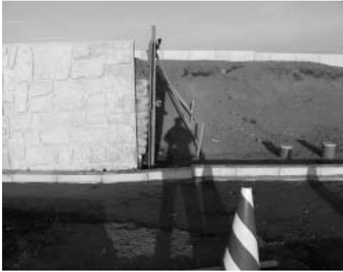
宅地の擁壁沈下
