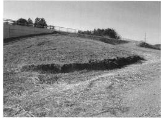
道路腹付け盛土クラック滑り
