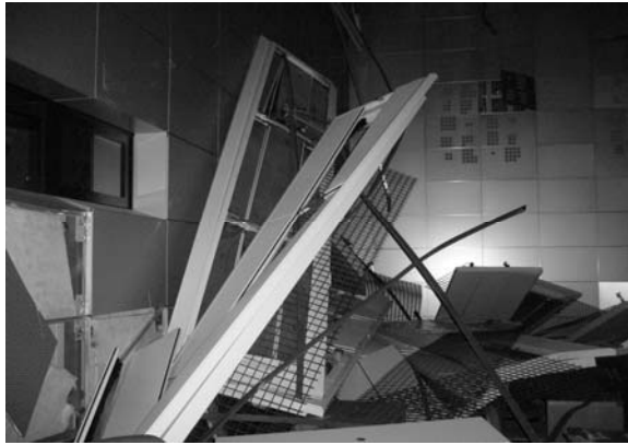
中ホール 300（天井パネル落下）
