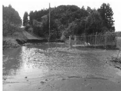
かすみがうら市：霞用水管漏水
