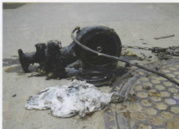
汚水ポンプに絡まったタオル
