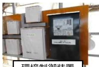
環境制御装置
