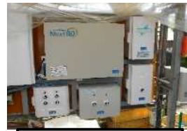
環境制御装置
