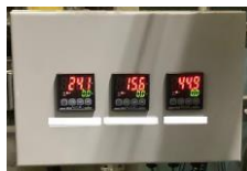
現場計器の例
