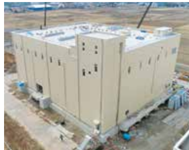
高度浄水処理施設(土浦市大岩田)
