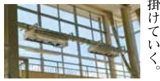
市町村立学校体育館の空調設備(守谷市立愛宕中学校)
