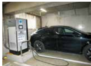
電気自動車と充電設備(県庁舎)
