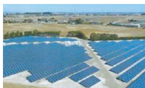
県内の太陽光発電施設
