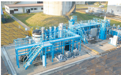
新しい高度浄水処理技術の実験施設(霞ヶ浦浄水場)
