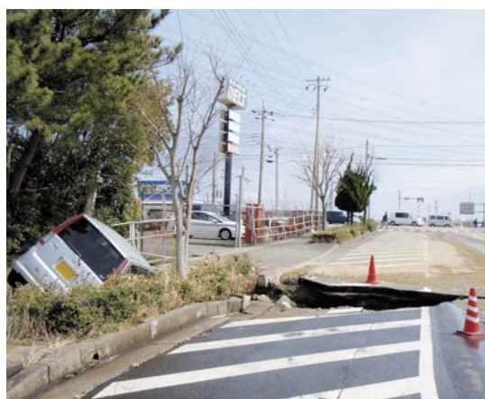
地震により陥没した道路 (神栖市)
