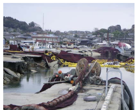
津波の被害を受けた大津漁港 (北茨城市)
