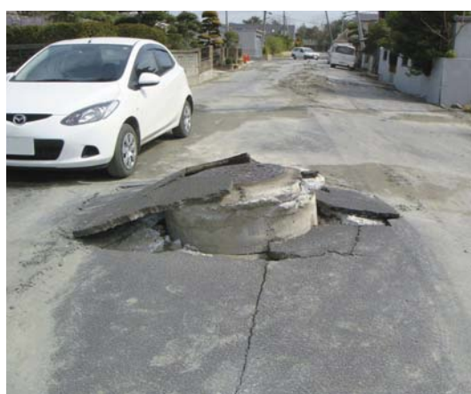
液状化によるマンホールの抜け上がり (潮来市)
