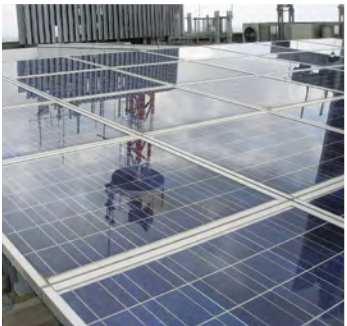
太陽光発電パネル(県庁舎屋上)
