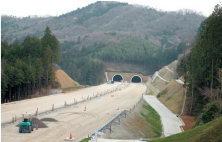
整備が進む北関東自動車道(建設中の唐桶山トンネル付近)
