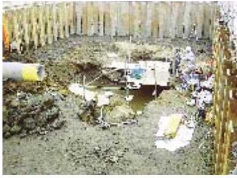
神栖町における有機ヒ素の汚染源と見られるコンクリート塊
