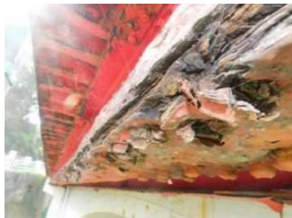
▲ 老朽化対策（要対策箇所イメージ）
