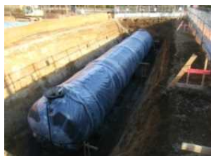
【耐震性貯水槽】 避難者への飲料水の確保 (笠間芸術の森公園 外8公園で整備済)
