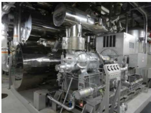
室内機(行政棟地下2階)
