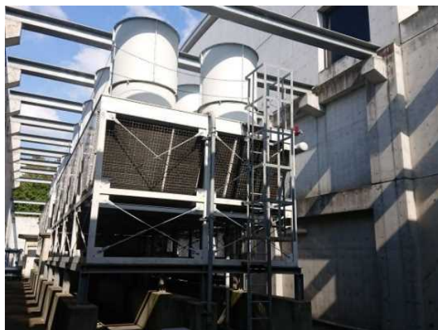
室外機(福利厚生棟脇)
