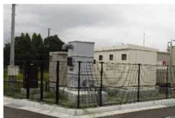
非常用発電機
