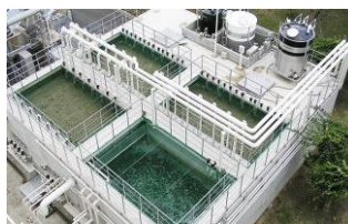
水処理システム
