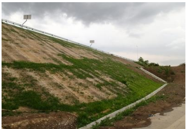
セメント改良土壌で硬度が30mm超での失敗事例
