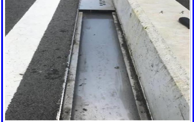
設置2年経過後の本体内部
