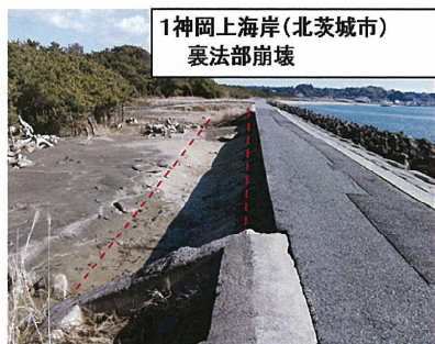
≪海岸堤防の被災≫
