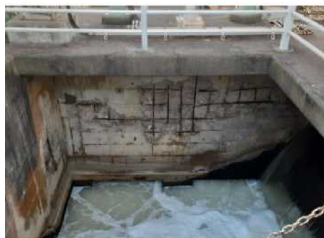
塩素混和池の鉄筋露出状況
