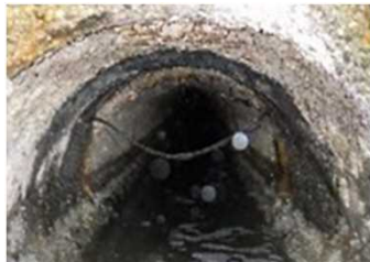
管渠の腐食状況
