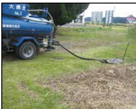
農集排の汚水受け入れ状況 (那珂久慈流域・大宮ポンプ場付近)
