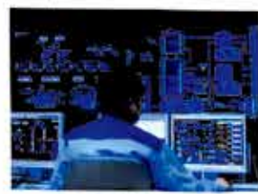
東京都下水道局より 水再生センター中央監視室風景
