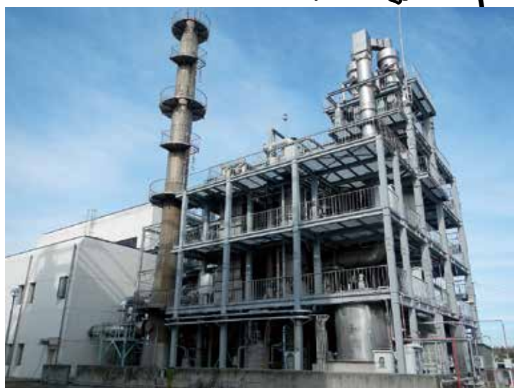
広域汚泥 1号焼却炉
