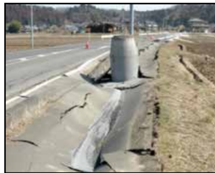
液状化によるマンホールの隆起 (常陸太田市)
