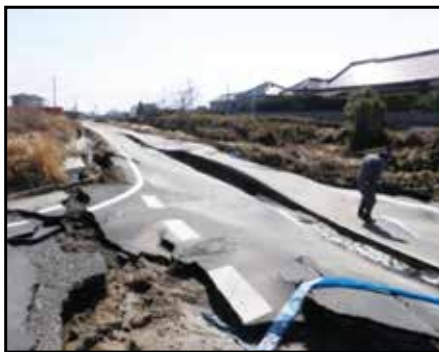
液状化による道路のうねり (鹿嶋市)
