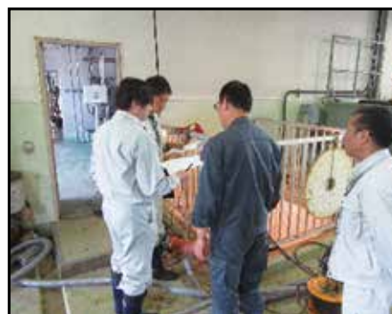
被災後のし尿処理施設の状況 (大子町・衛生センター)
