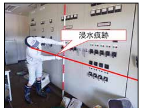
かつら水処理センターの浸水状況 (城里町公共・かつら水処理センター)
