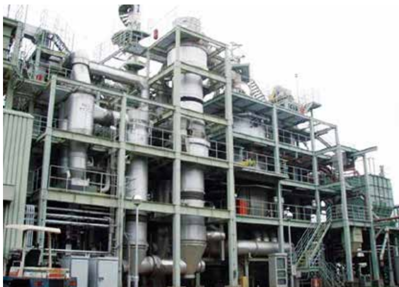
広域汚泥 1号焼却炉
