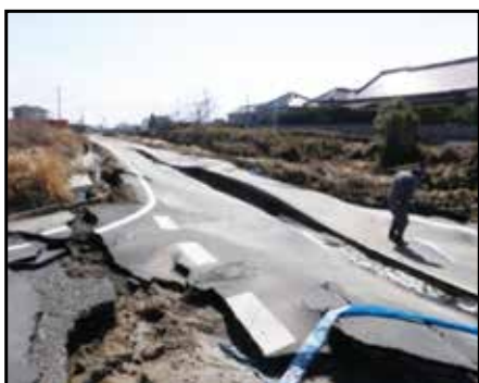
液状化による道路のうねり (鹿嶋市)
