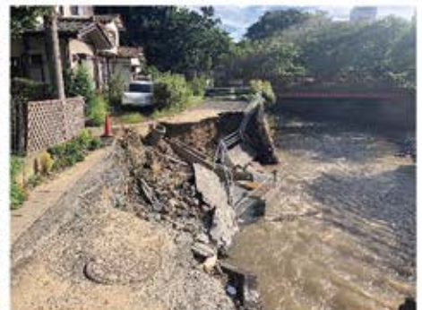
管渠の被災状況 (日立市：神峰町)
