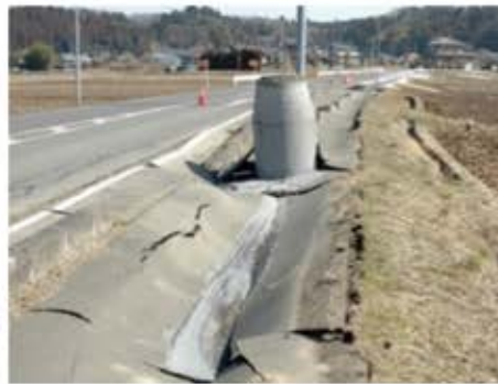
液状化によるマンホールの隆起 (常陸太田市)
