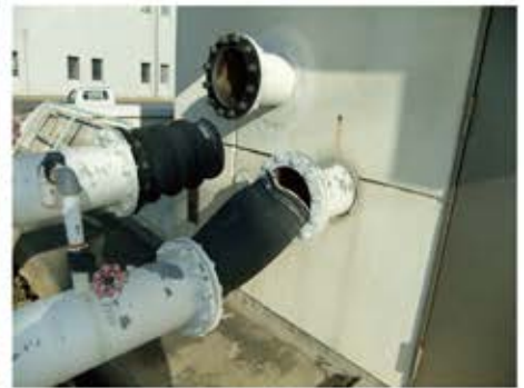
排水管の損傷 (那珂久慈浄化センター)
