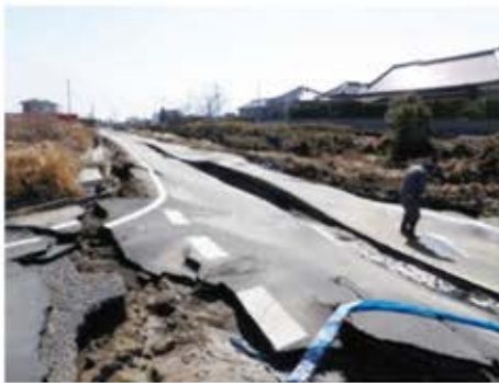
液状化による道路のうねり (鹿嶋市)
