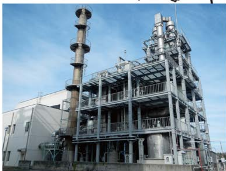
広域汚泥 1号焼却炉
