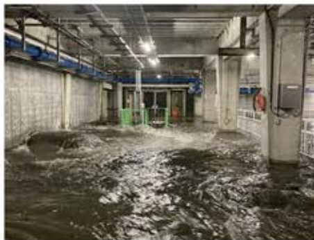
処理場の浸水状況 (日立市：池の川処理場)
