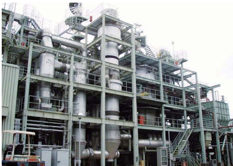
広域汚泥 1号焼却炉
