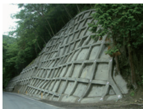
土砂崩れを防止
