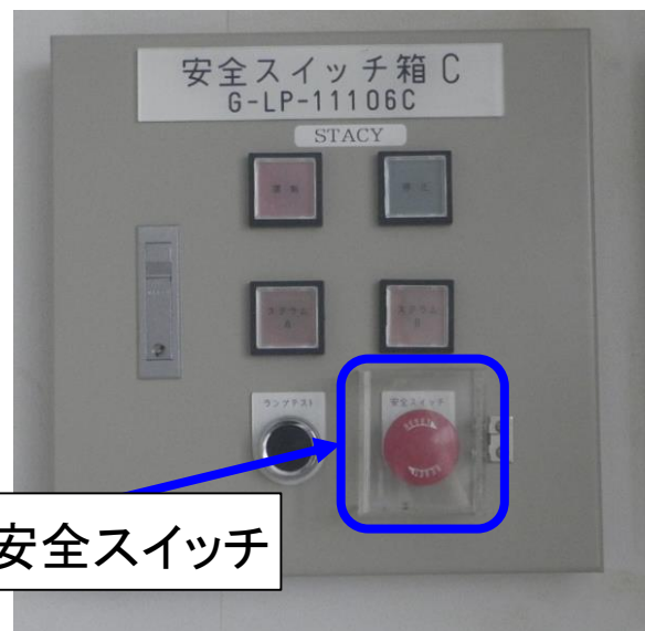
制御室外の安全スイッチ
