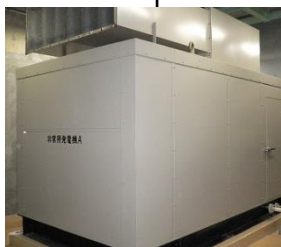
非常用発電機
