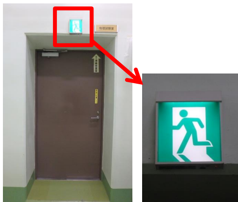
誘導灯(避難口)
