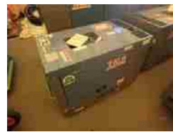
⑥可搬型発電機
