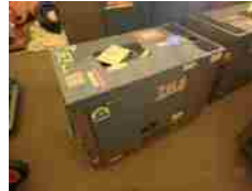
⑦可搬型発電機
