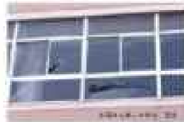
体育館窓ガラスの損傷
