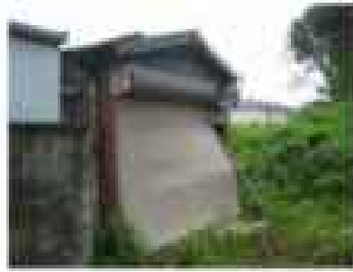
シャッターの外れ
