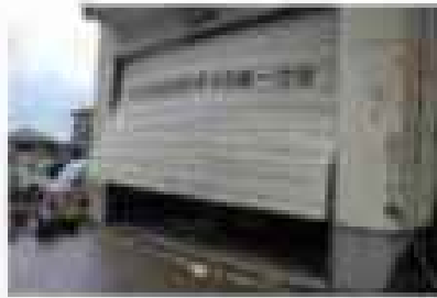
シャッターの変形
