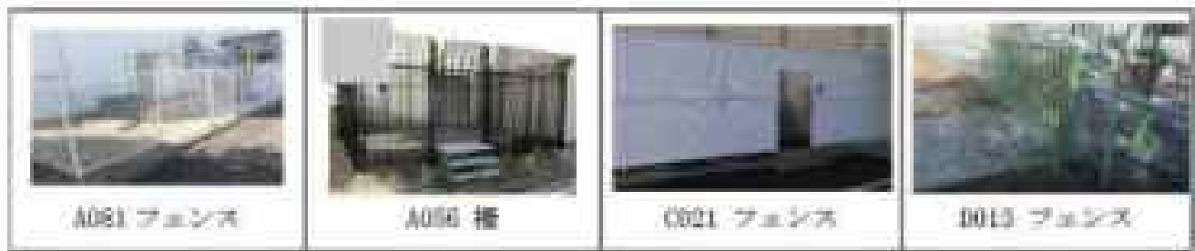
図 3.1-1 被害事例から損傷するが廃散しないと判断されるもの (本図は代表例を示す。)
