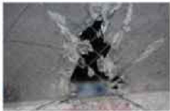
ガラスの被害状況（飛来物衝突後）
