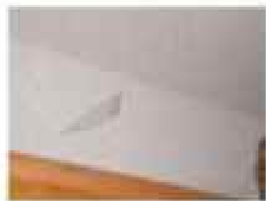
破損した窓ガラス片の室内壁面への突き刺さり
