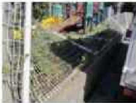
フェンスの変形
