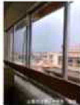
屋外に落ちた窓ガラス
